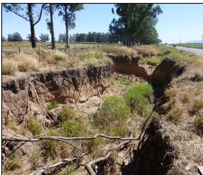
Figura 14: Erosión hídrica extrema a la vera de la ruta 336 en Gobernador Garmendia, Tucumán.
